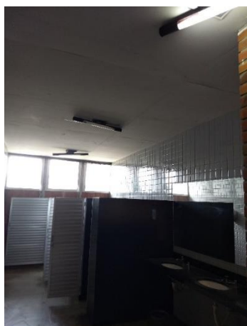
(c) Banheiro feminino: luminárias
