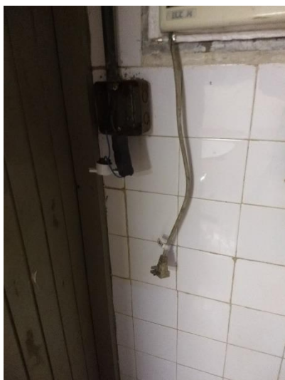
(a) Fiação ao lado da porta do banheiro (fiação do ar-condicionado) necessita de troca
