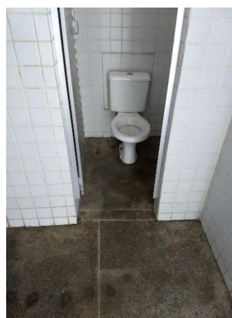
(b) Sanitários sem tampa, marcas de goteiras
