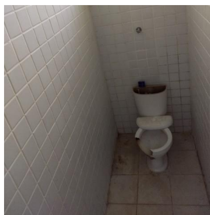
(b) Sanitário Quebrado
