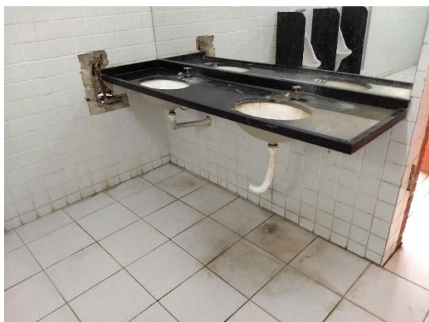
(a) Sifões rompidos, reforma inacabada
