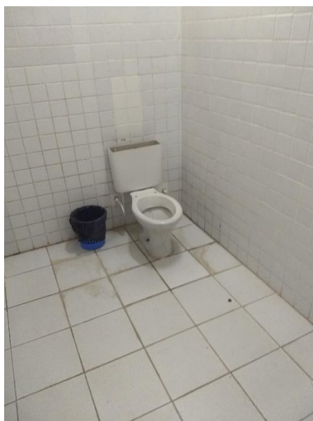
Figura 7 – Banheiro do Bloco CTA: tampa de descarga quebrada e sanitário sem tampa
