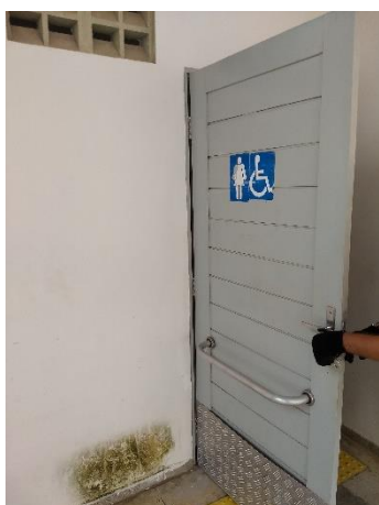
(a) Fungos na parede
