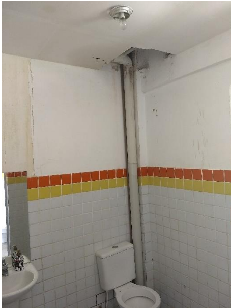
(a) Feminino térreo: problemas no teto, luminária, tampa de vaso ausente
