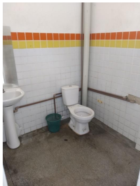
(d) Masculino térreo: oxidação de peças, vazamentos e tampa de vaso ausente
