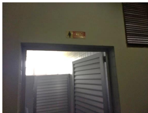
(b) Banheiro feminino: falta de privacidade
