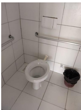
(b) Sanitário sem tampa
