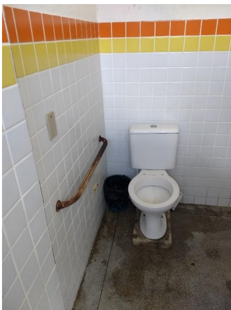
(c) Masculino térreo: oxidação de peças, vazamentos e tampa de vaso ausente
