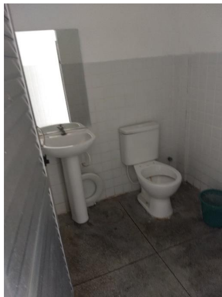
(b) Feminino 1º pavimento: tampa de sanitário ausente
