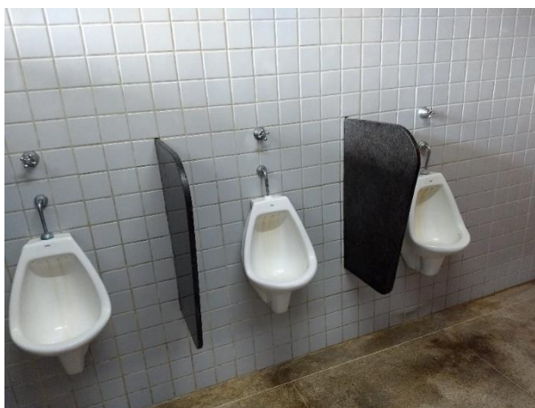
(b) Banheiro Masculino: piso manchado
