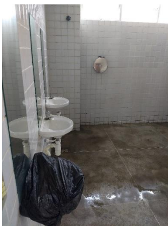
(a) Vazamentos, infiltrações e lavatório interditado
