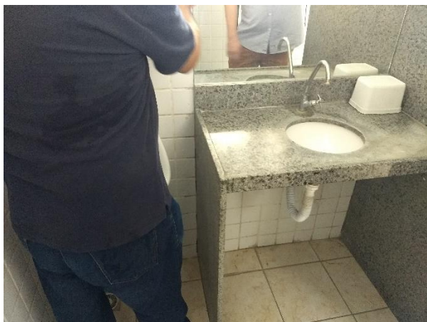
(b) Banheiro masculino 1º andar: necessidade de divisória entre o lavatório e o mictório
