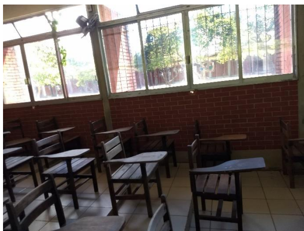
Figura 5 – Ausência de uma grade de janela na sala CTD 105
