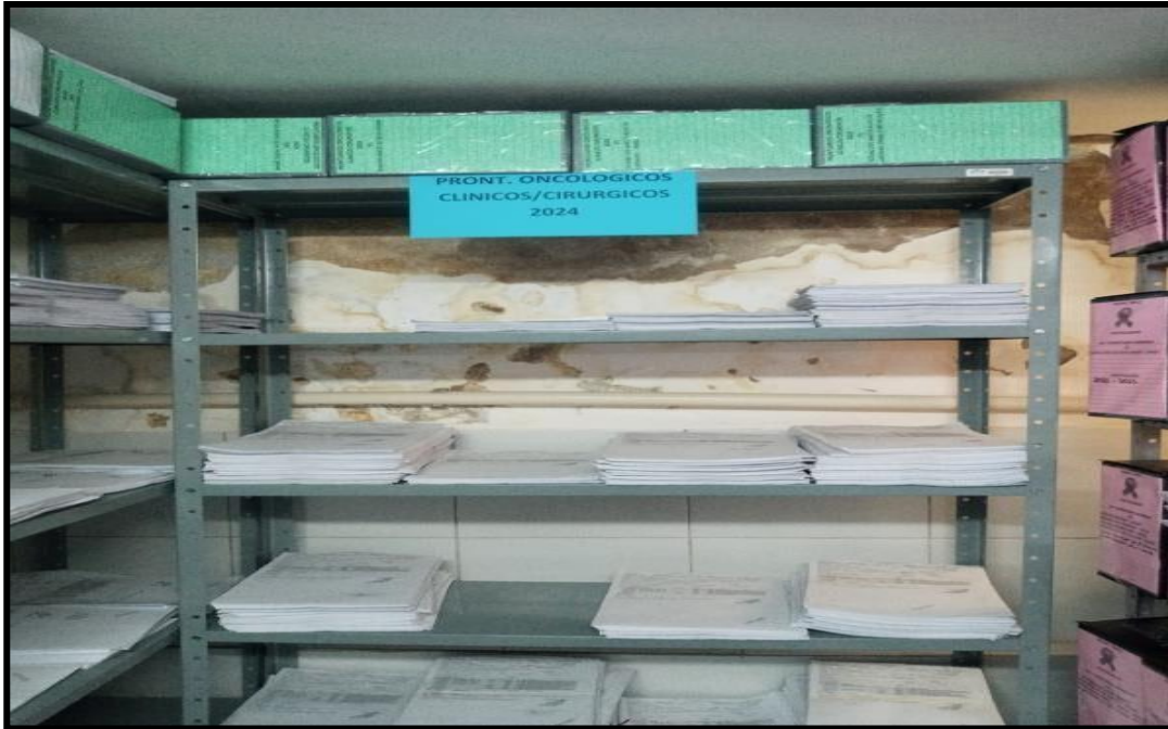
Figura 13 – Infiltração no Arquivo SAME
